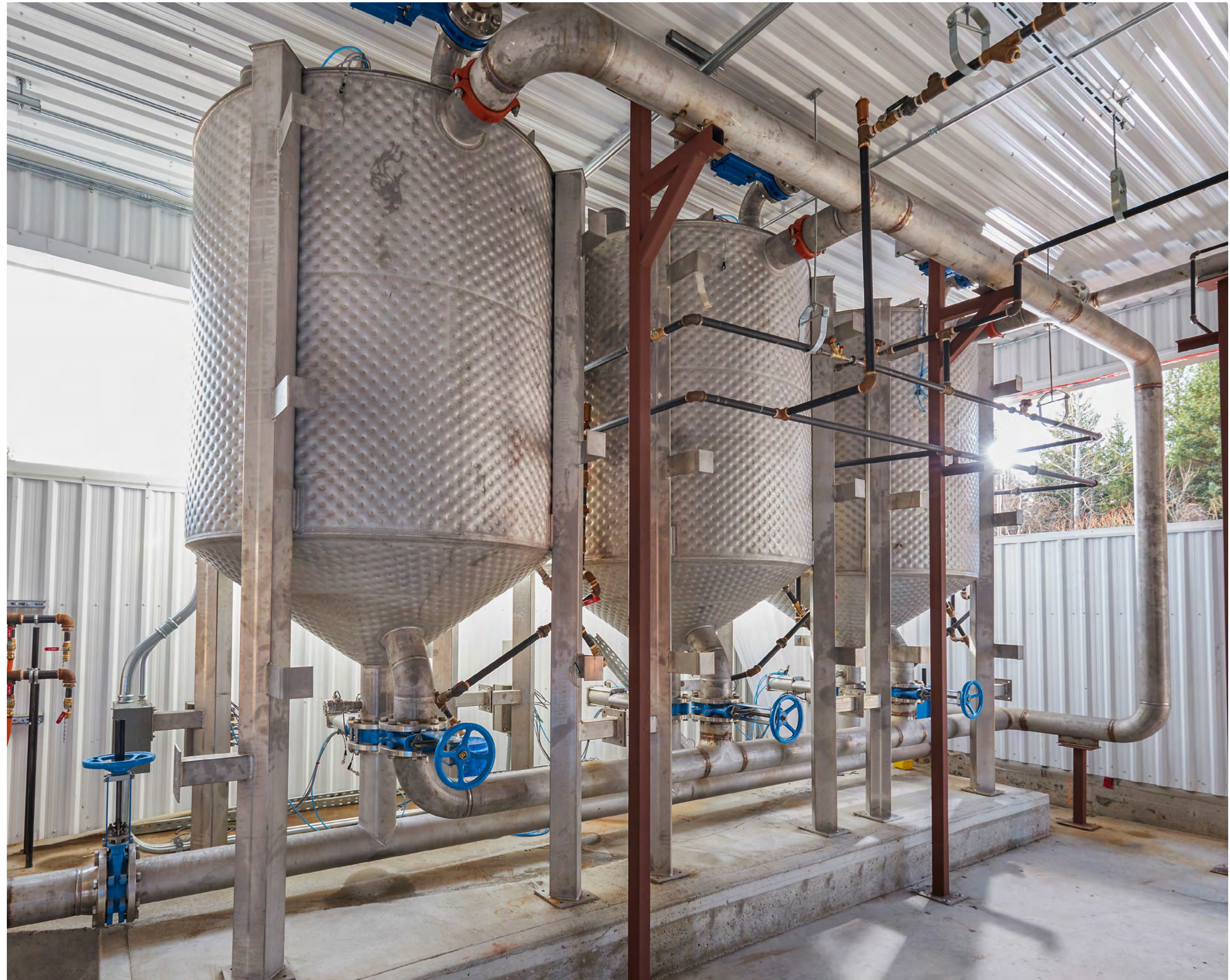
Réservoirs de retenue à l'usine de biogaz ZooShare, Toronto, Ontario
